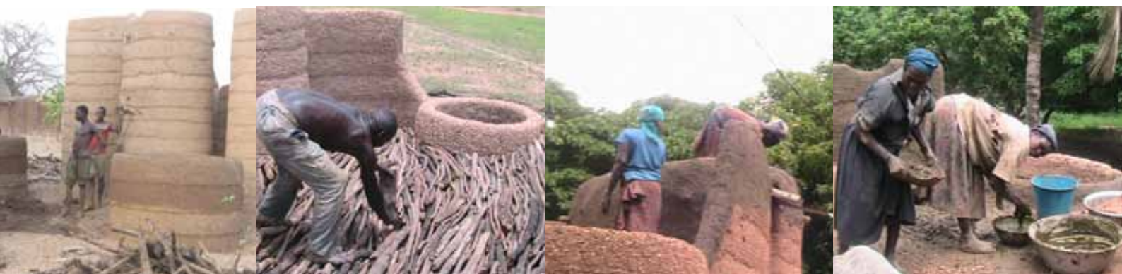
Figures 2, 3, 4 et 5 : Étapes de construction : dallage, crépissage et enduits lors de la mise en oeuvre du projet de réhabilitation des tatas. Projet financé par la Fondation Prince Claus des pays Bas en 2011. © A. B. Karka/Site Koutammakou
